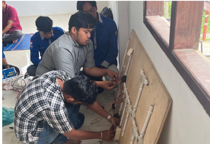
Beberapa pemuda Gampong Padang Sakti, Kecamatan Muara satu, Kota Lhokseumawe, sedang mengikuti pelatihan instalasi listrik, Senin (19/8/2024).Foto :Is
